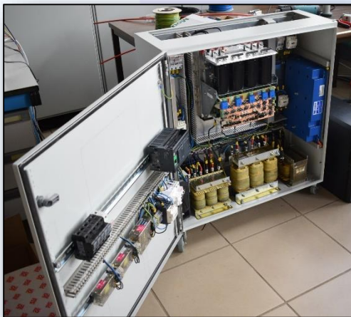
Convertidor y ultracondensador para el generador.
