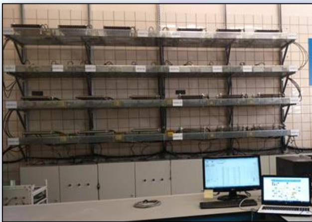
Red a escala donde se instalaron los múltiples generadores.
