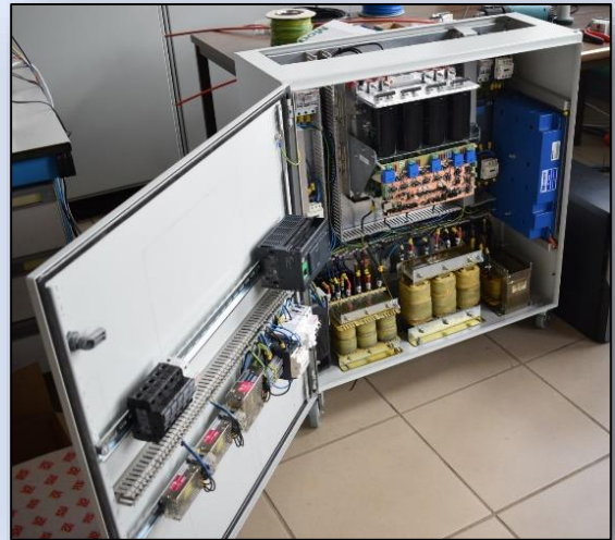
Convertidor y ultracondensador para el generador.
